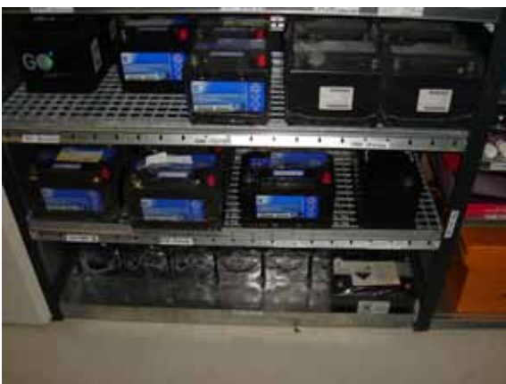
Lekbakken t.b.v. accu opslag
